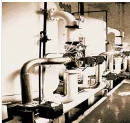
Impianto di filtraggio del Comune di Leggiuno.
